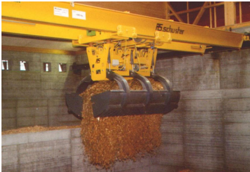
Heizwerk Wilderswil automatische Krananlage zur Beschickung von Heizkessel
