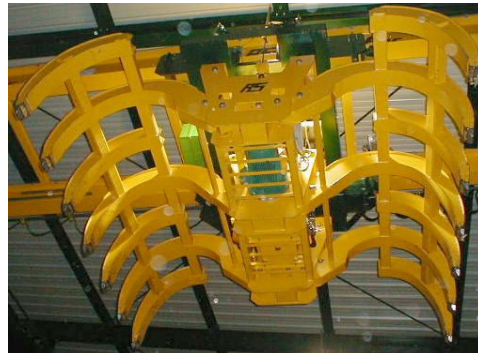
Holztrocknungsanlage Frankenmarkt automatische Krananlage zur Beschickung einer Rindenfeuerung
